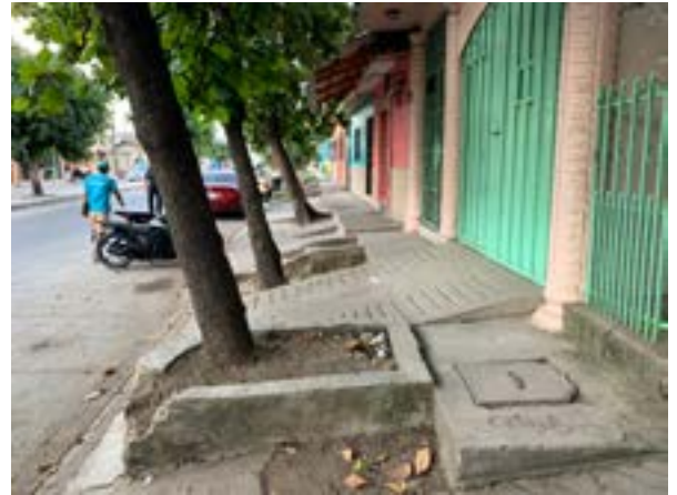
Desniveles y falta de continuidad de la acera Foto: Ciudad Emergente (2019)
